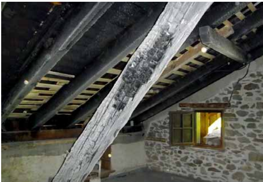
Tetto incendiato causa errata posa camino
