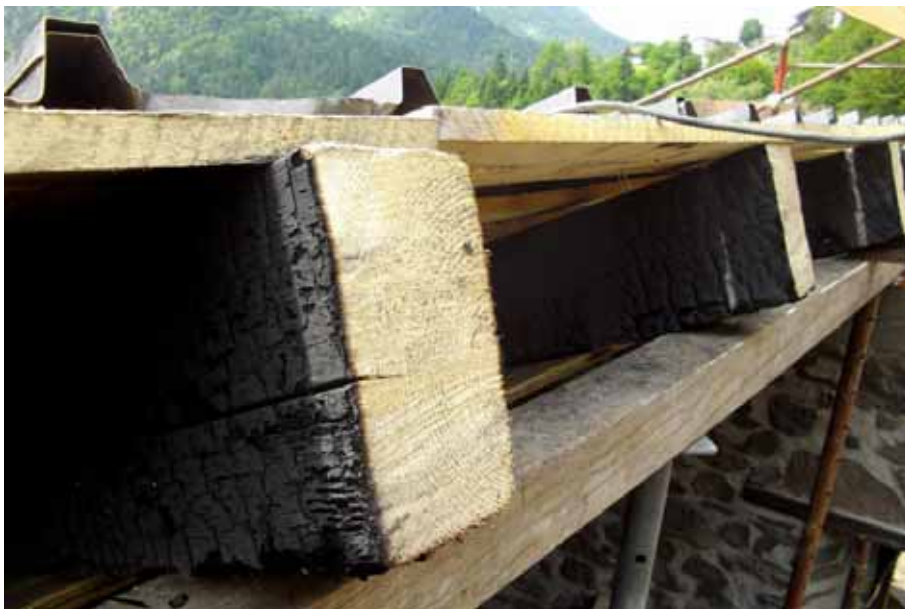
Tetto incendiato causa errata posa camino
